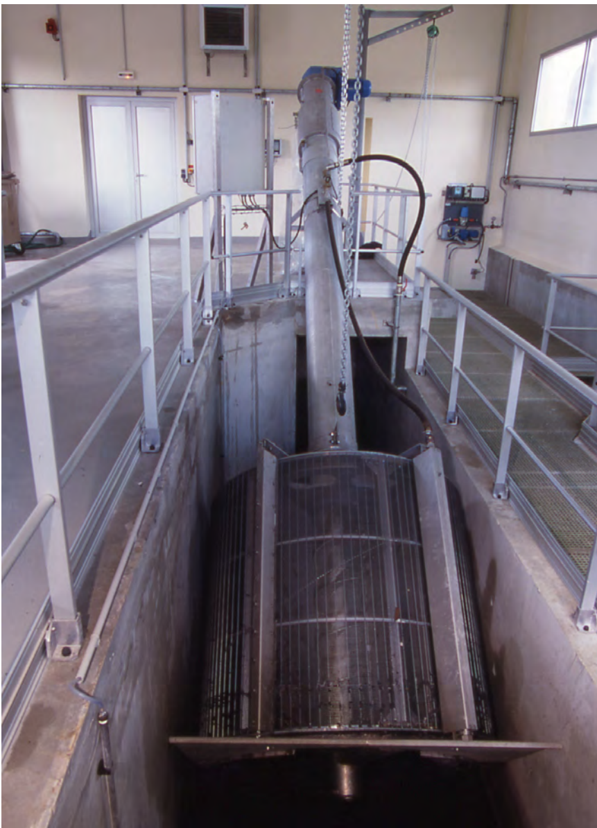
Bild 6: Siebanlage aus Edelstahl Rostfrei zur Abwasseraufbereitung in einer Kläranlage (Foto: Ugitech GmbH, Renningen / Ondeo IS, Paris la Défense(F))
