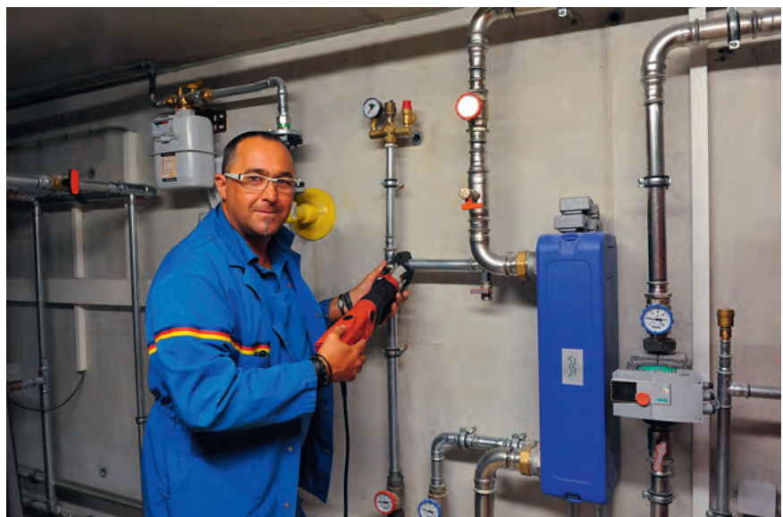
Bild 4: Trinkwasserinstallation und Warmwasserbereitung mit Rohren und Pressfittings aus Edelstahl Rostfrei (Foto: Esta Rohr GmbH, Siegen / Installationsunternehmen Siegfried Bruni)
