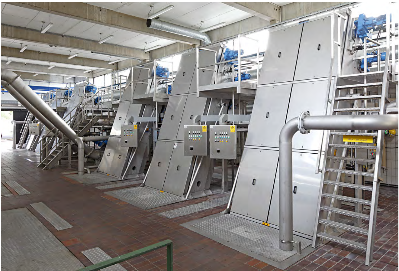
Bild 1: Edelstahl Rostfrei in Einrichtungen zur Abwasserbehandlung (Foto: Huber SE, Berching)
