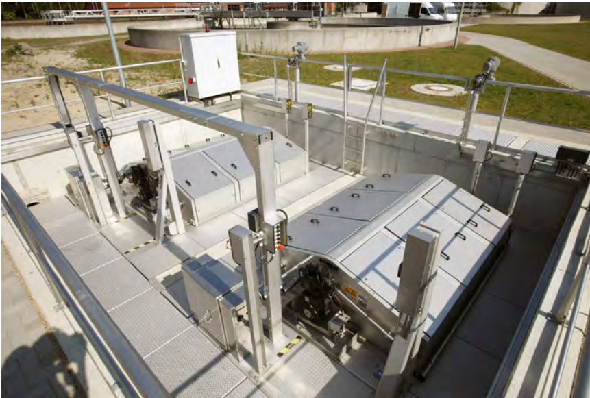
Bild 5: Abwasserbehandlungsanlage aus Edelstahl Rostfrei zum Abscheiden feinsten Feststoffe (Foto: Huber SE, Berching)
